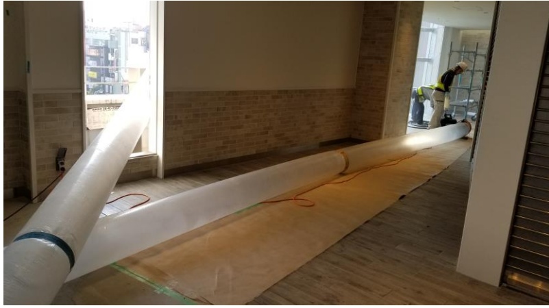
ダクトにて排気
