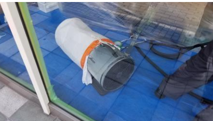
ダクト排気(フィルター)
